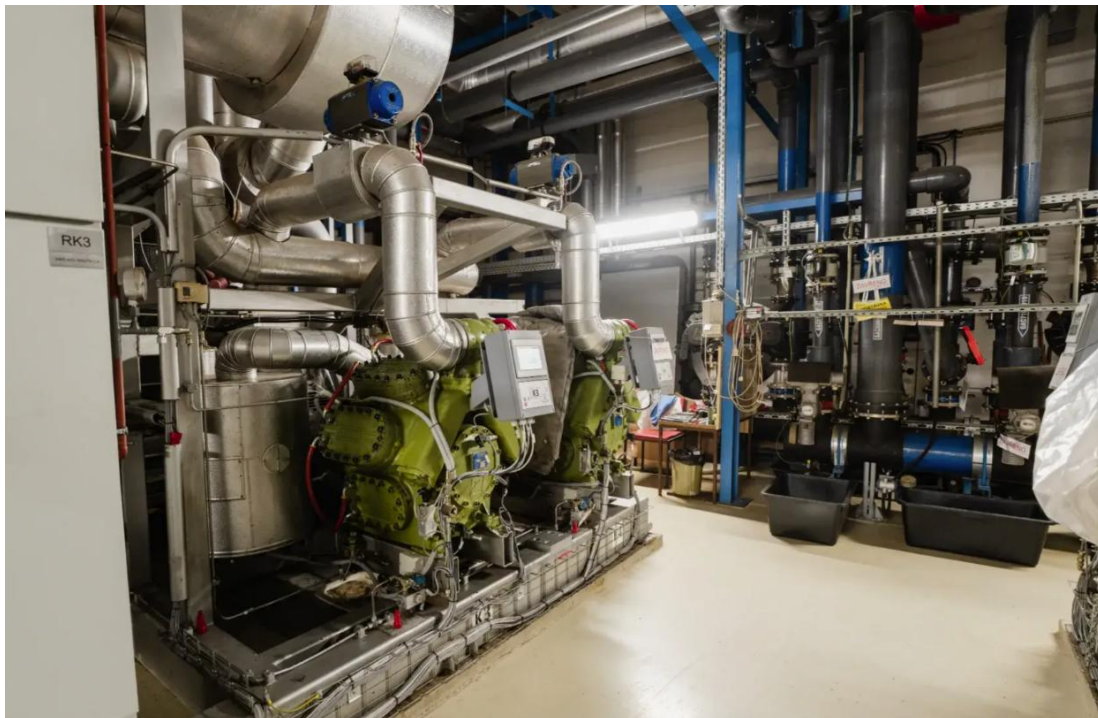
Obrázek 2: Technické vybavení teplárny 2
